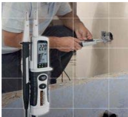
MEDIDORES DE GRANDEZAS ELÉTRICAS
